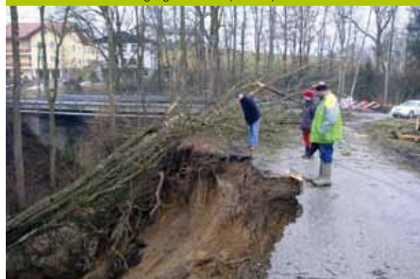
Unterspült - Hangrutschung beim Gießgraben (Oberösterreich)
